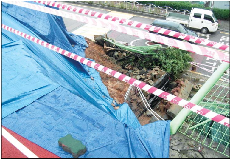
갑자기 쏟아진 비에 화성시 A중학교 운동장과 인도 사이에 있던 가로 10m 높이 5m의 옹벽이 무너져 내린 현장.
