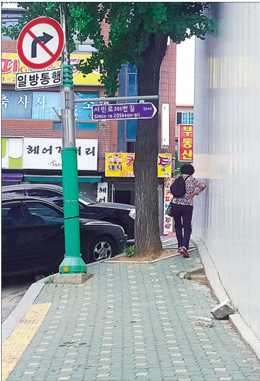
성남시 수정구 태평로 성남시립의료원 건립 공사장에 설치된 안전펜스로 인해 축소된 보도(인도)를 한 시민이 어렵게 지나고 있다.
